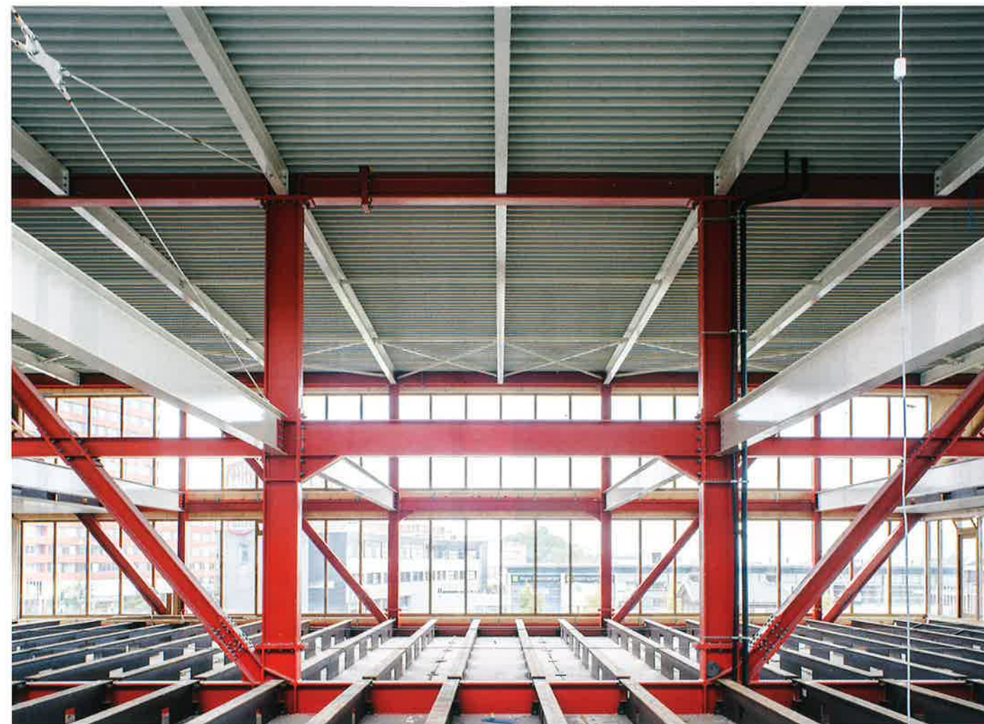
De stabiliteit van de constructie is in beide richtingen gewaarborgd door portaalwerking.
