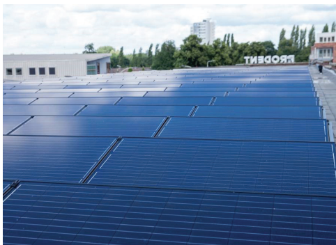
De eerste invulling aan innovatieve duurzaamheid door de aanleg van een warmtenet met biomassaketel, zonnepanelen en 20 laadplekken voor elektrisch rijden.
