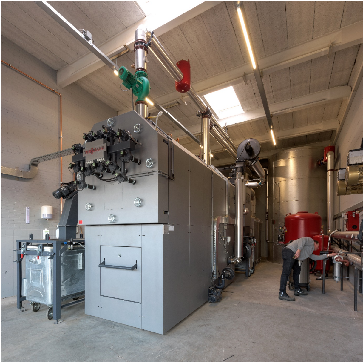
Houtgestookte verwarmingssysteem Viessmann Vitoflex 300-UF in De Nieuwe Stad.
